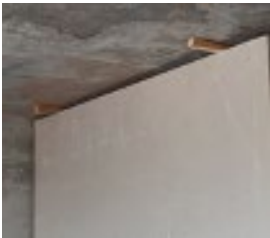
8) Colocar los paneles dentro del trazado y anclar a los Insertos, colocar las cuñas de madera en las juntas de dilatación entre la losa y el piso.
