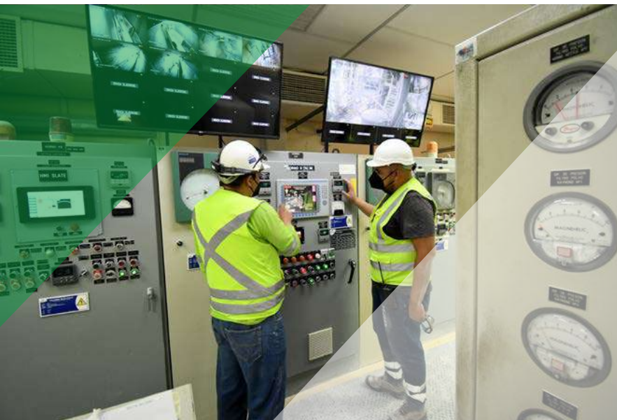
SALA DE CONTROL FABRICA YESO DE PLANTA CONCHA Y TORO.
