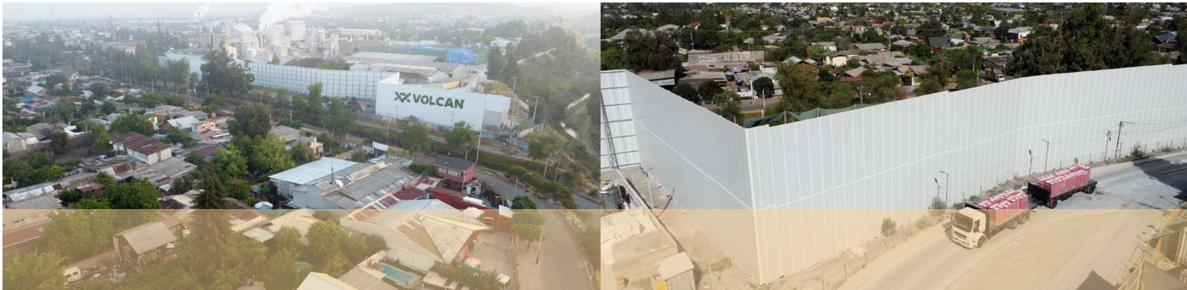
MURO ACÚSTICO CONSTRUIDO EN 2022 EN COMPAÑÍA INDUSTRIAL EL VOLCÁN (CONCHA Y TORO)
